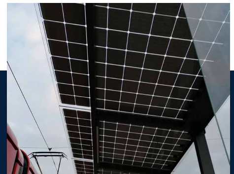
Moduły PV na wiatkach przystankowych
